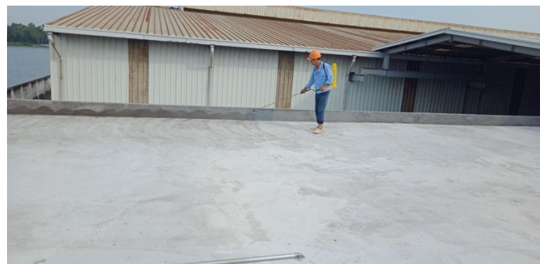
Hình ảnh: Phun chống thấm sàn mái nhà máy AAC Bắc Ninh
